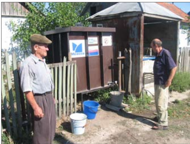
Obr. 17: Zásobník pro přečištěnou podzemní vodu, která je využívána místními obyvateli k užitkovým účelům
