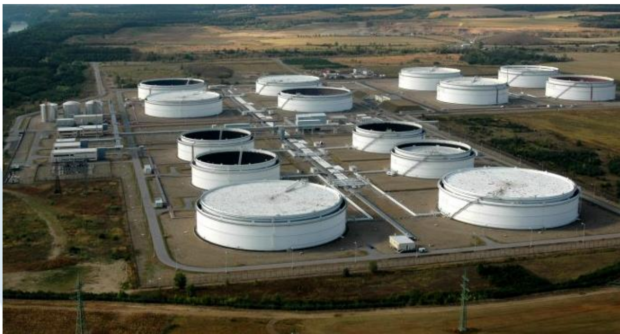
Nádrže na ropné produkty (nahore) a na ropu společnosti MERO (dole)
