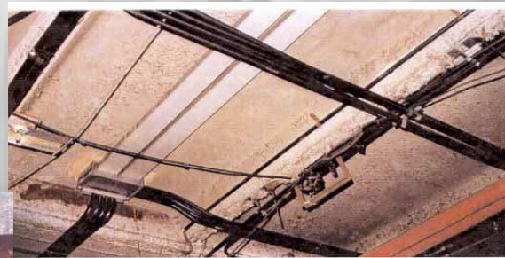
Obr. 3/V – nástřik azbestu – LIMPET – nedopatřením aplikován i na betonovou desku
