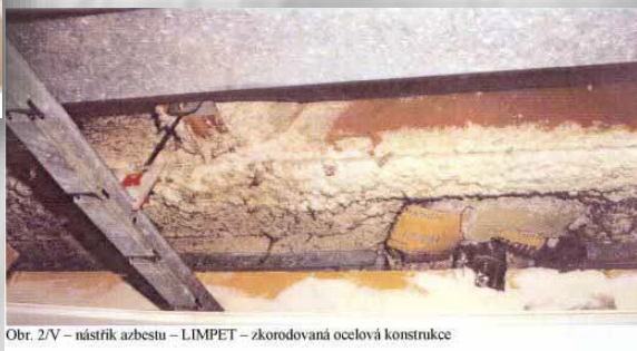
Obr. 2/V – nástřik azbestu – LIMPET – zkorodovaná ocelová konstrukce
