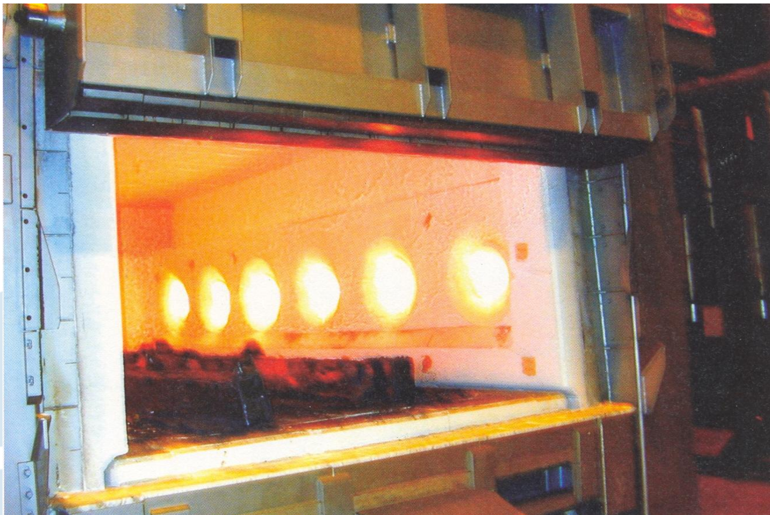
Pohled do vnitřku vozové pece na umístění hořáků
