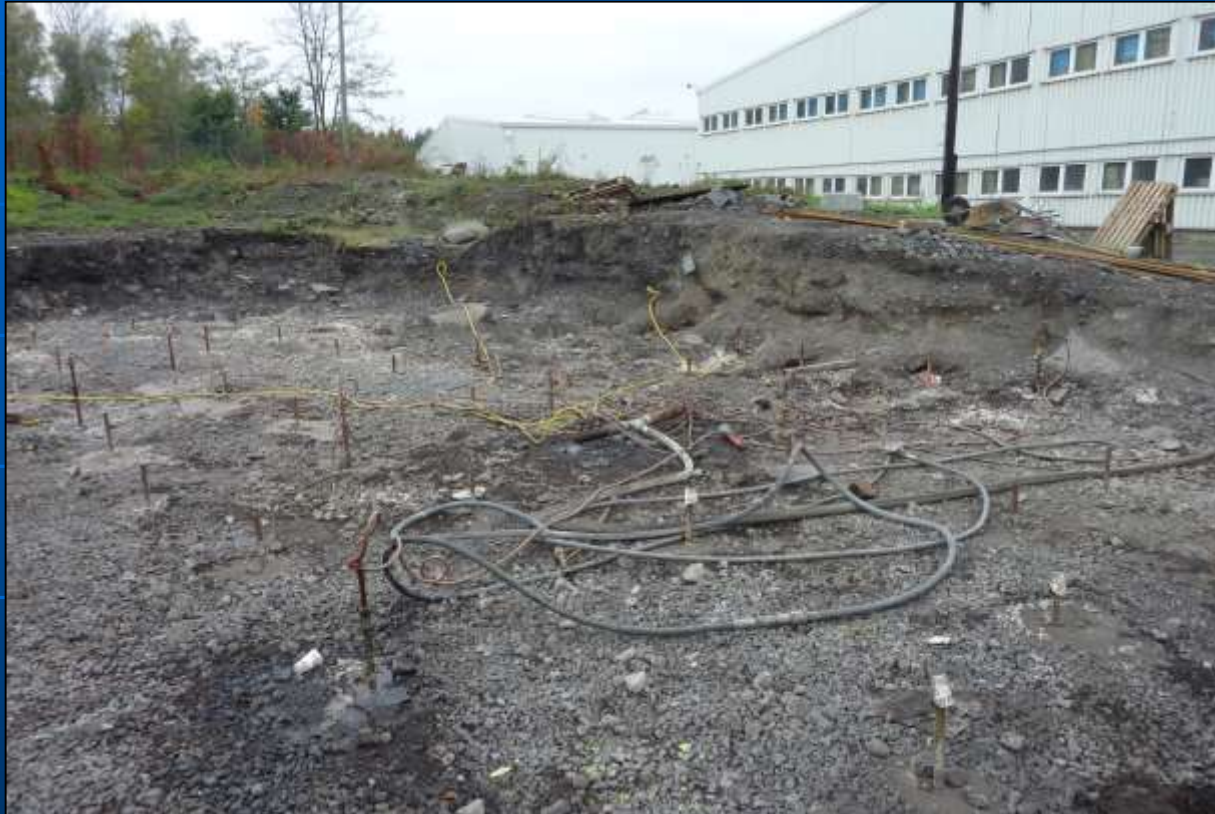
Prochlazování podložní důlní hlušiny vodou
