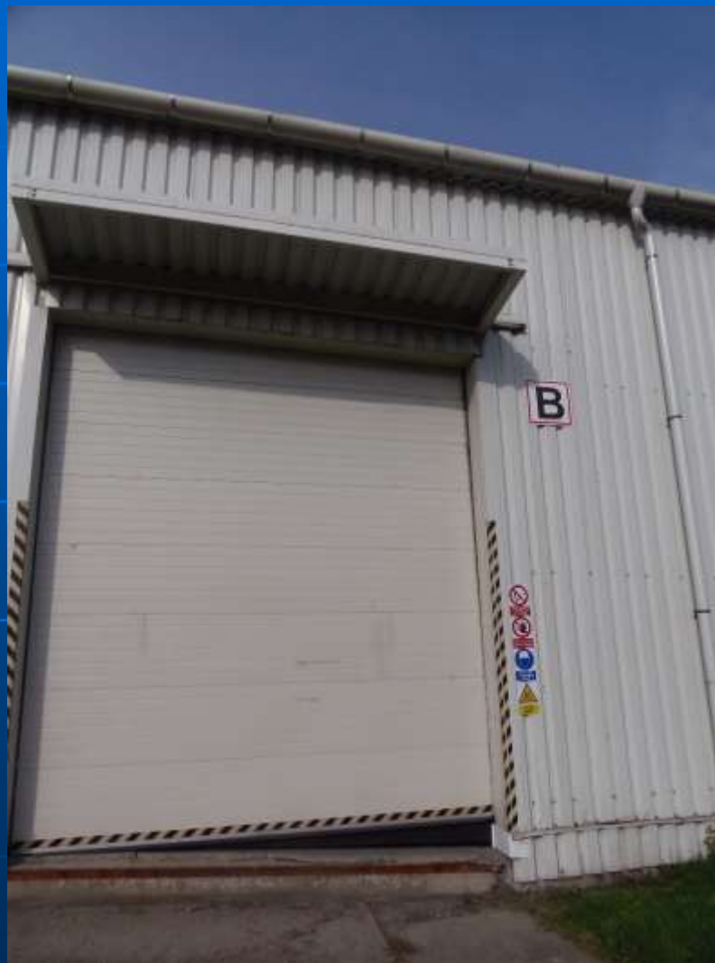
Pokles základové patky a následná deformace objektu
