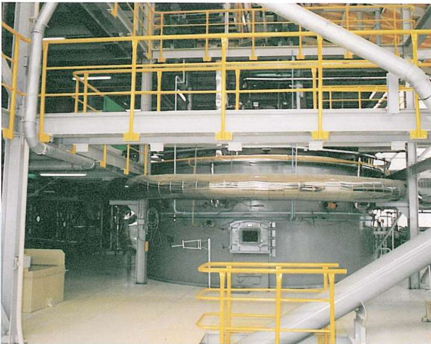
Gesamtansicht des Ofensystems Total view of furnace system
