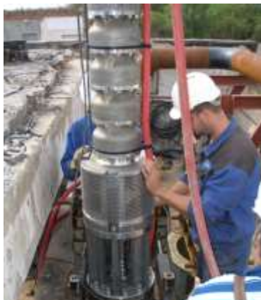
čerpadlo důlních vod
