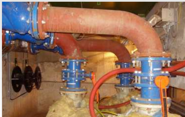
konec výtlačného potrubí čerpadel
