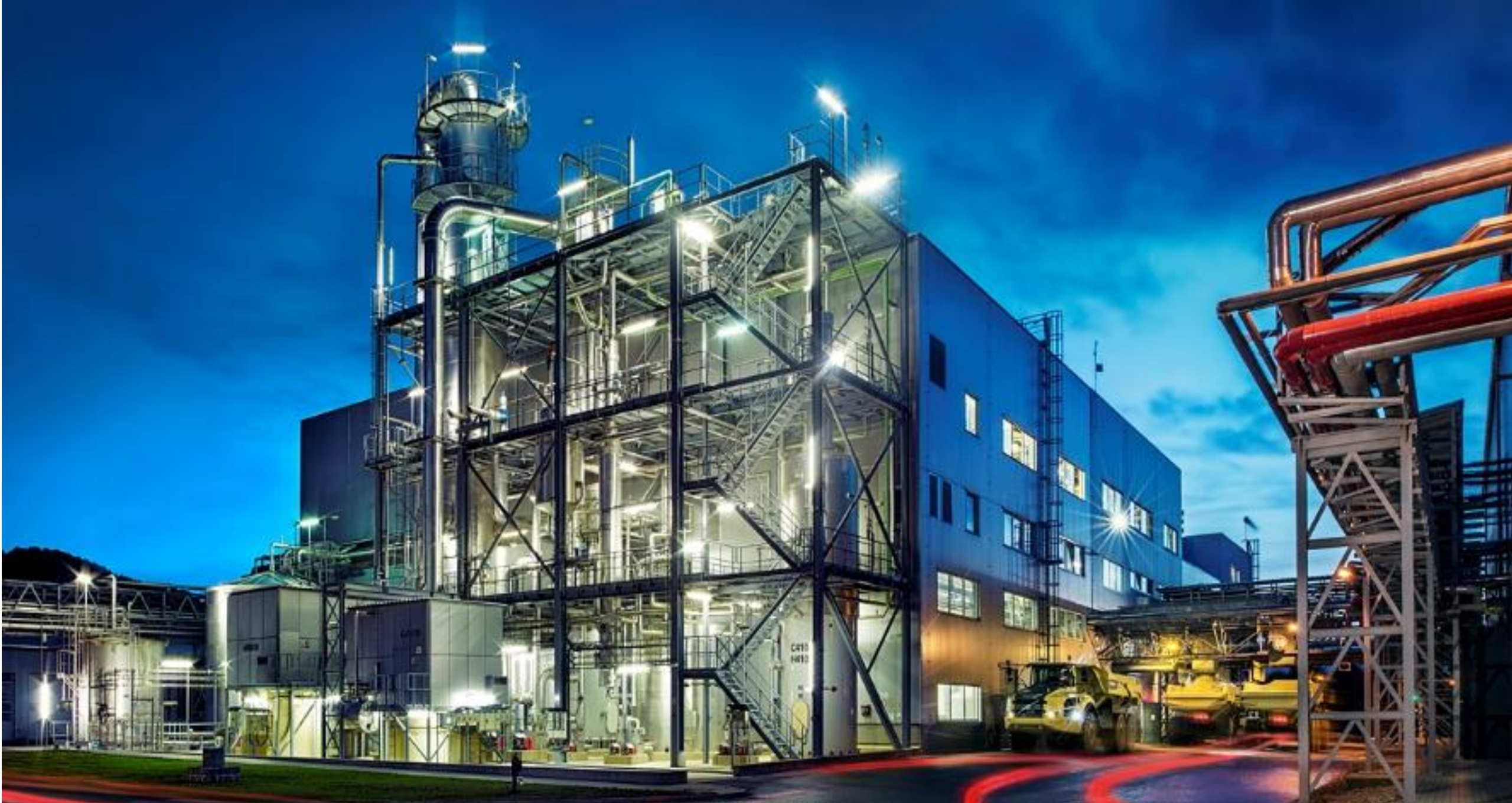
Neutralizační a dekontaminační stanice – o. z. TÚU Stráž pod Ralskem
