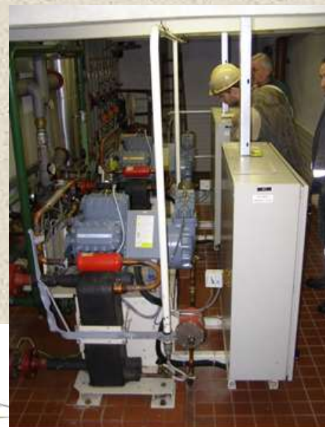
Tepelné čerpadlo šachta Svornost
