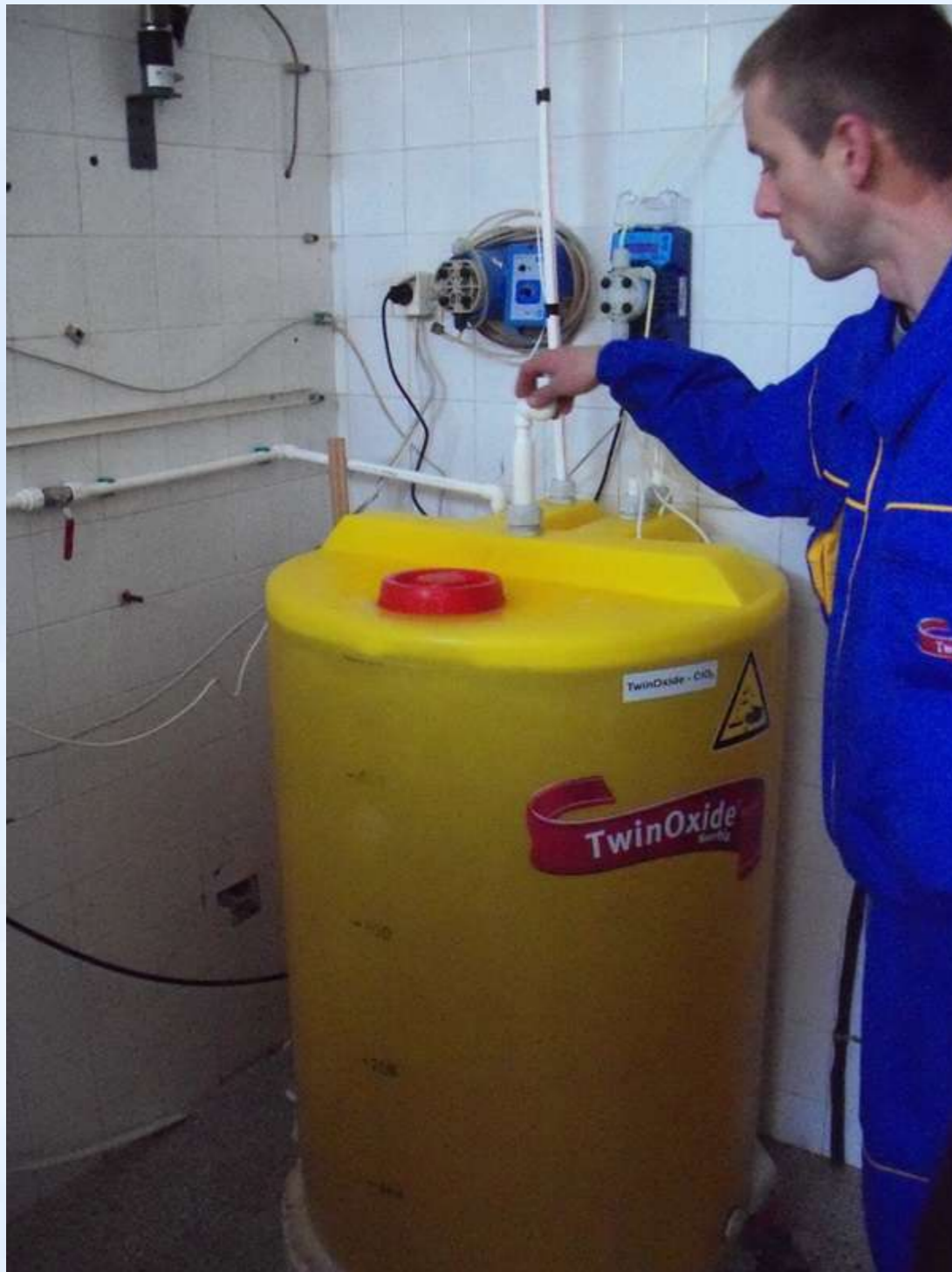
Zásobní a dávkovací nádrž
