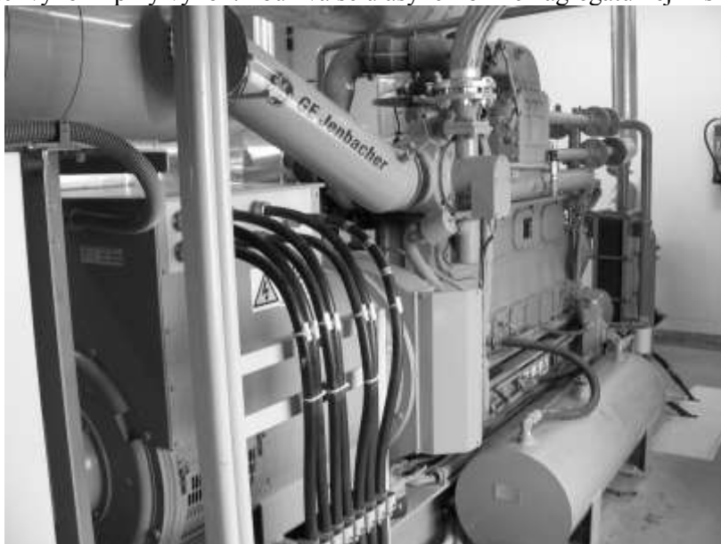
Obr. 7: Kogenerační jednotka fy GE Jenbacher
