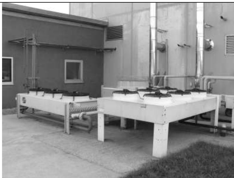
Obr. 6: Chladiče pro chlazení motoru kogenerační jednotky
