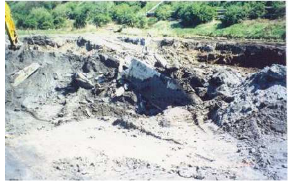
Jedna z podzemních konstrukcí (bývalá armaturní komora) plná kamenouhelného dehtu
