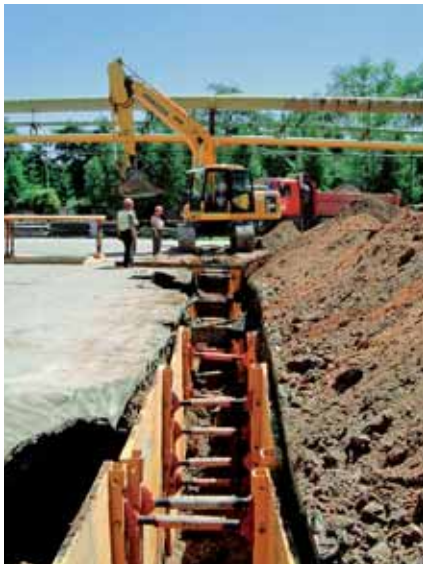
Dekontaminační stanice pro čištění podzemní vody z oblasti bývalé plynárny
