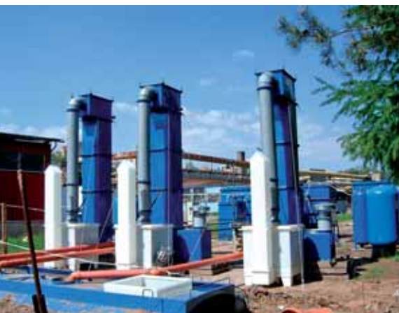
Dekontaminační stanice pro čištění podzemní vody z oblasti bývalé plynárny
