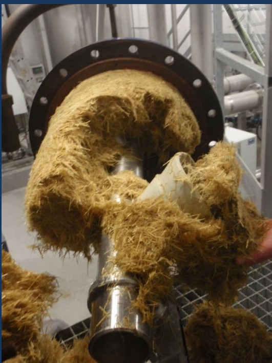
Čištění sít je pracné a časově náročné při odstávce technologie
