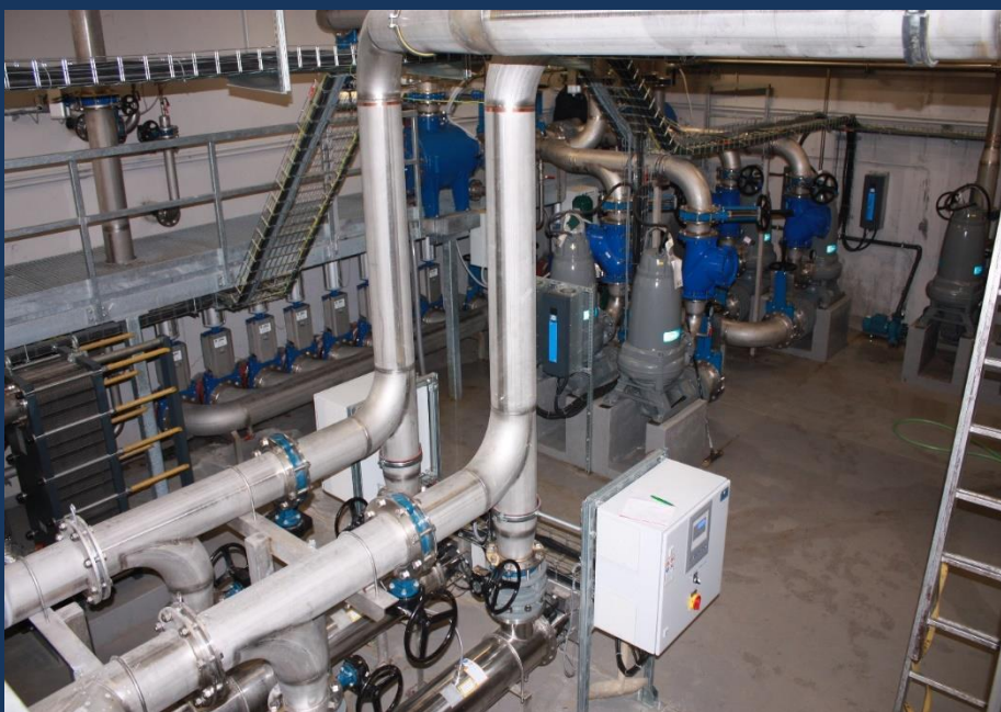
Pohled do nejdražší strojovny pro dva 50 m 2 bazény v ČR
