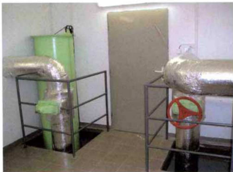
Tepelná izolace potrubí nátoku do vodojemu.
