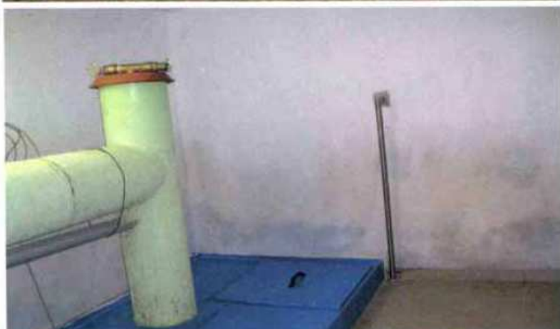
Ucpání větracích otvorů vyvedených nad hladiny a odvětrání stropu komor větrací hlavici.
